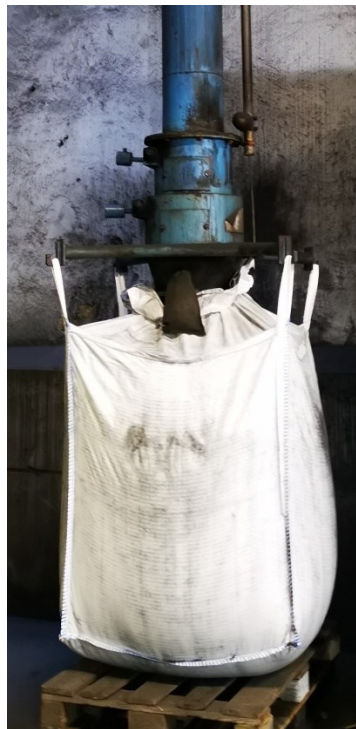
Abbildung 5: Beispiel einer Staubabsaugung in einen Bigbag (Quelle: Partnergießerei).
