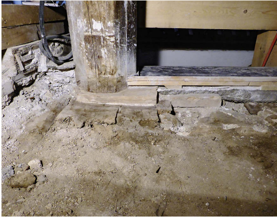
22 Die Mittelstütze im Saal des 2.Obergeschoss steht auf mehreren Brettern auf, die zum Teil hohl-liegen.
