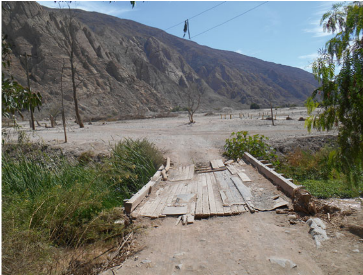
Abbildung 6.4 Baufällige Brücke über den Fluss Copiapó. (Quelle: Eigenes Foto, 20. April 2017 in Pabellón)
