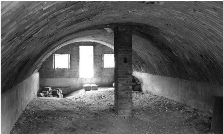
Abb. 3: Das Tonröhrengewölbe in einer der Baracken vor den Konservierungsmaßnahmen, April 2014. Quelle: Fotosammlung Manfred Deiler, Landsberg am Lech.
