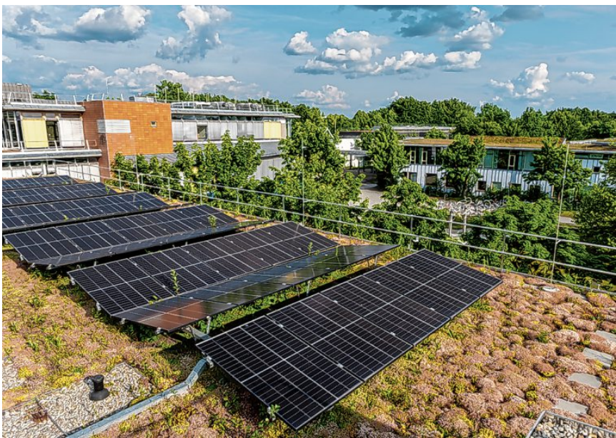
Die Universität Augsburg erneuert auf ihren Gebäuden Photovoltaikanlagen und baut diese weiter aus.
