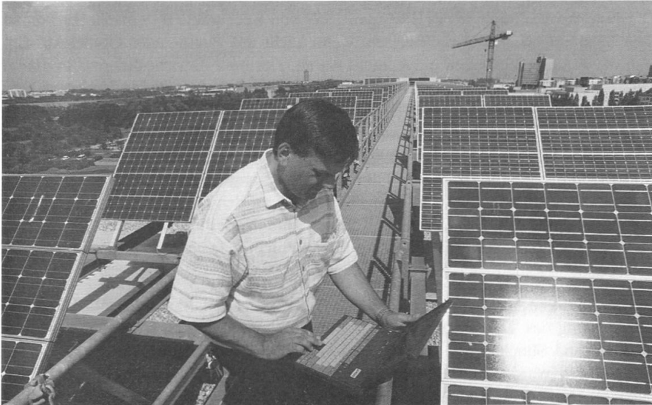
Auf dem Dach des EKM-Gebäudes des Augsburger Physik-Instituts ist die derzeit größte Photovoltaik-Anlage einer deutschen Hochschule installiert. Foto: Silvio Wyszengrad.
