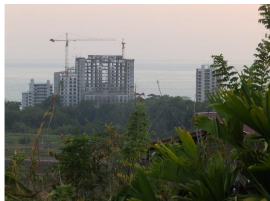
Abb. 34: Investitionsruinen (Hotelbauten) in Jacó
