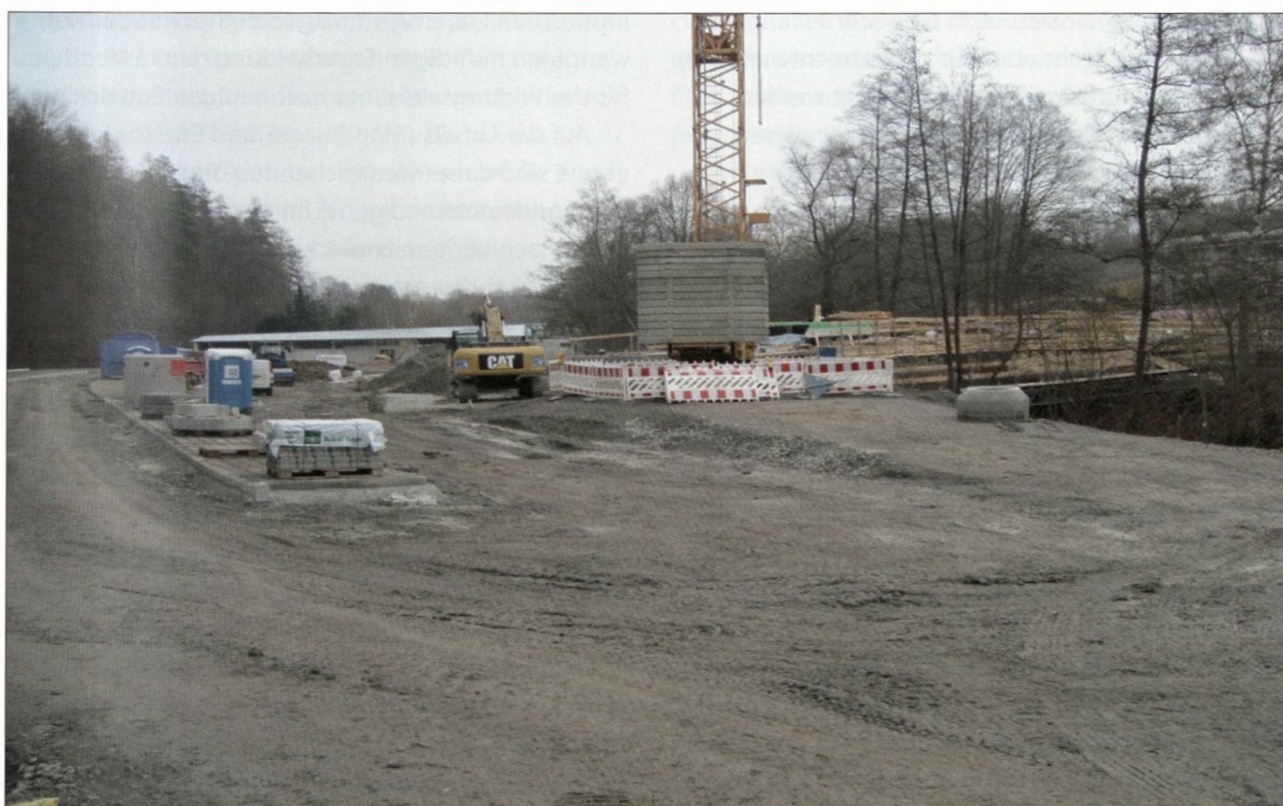
Beispiel für die Auffüllung eines durch Rechtsverordnung festgesetzten Überschwemmungsgebiets im HQ-10-Außenbereich in Backnang zugunsten neuer Parkplätze
