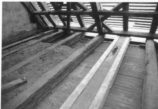
Abb. 8 Heilig-Geist-Spital, Dachstuhl mit freigelegten Balkenköpfen, Foto 1998
