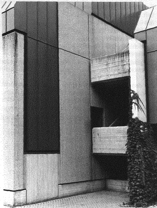
Am Hörsaalgebäude ist Waschbeton eine Applikation im Verbund mit Blechverkleidungen, der Sichtbeton hat dienende Funktion. Foto: Scheuermann
