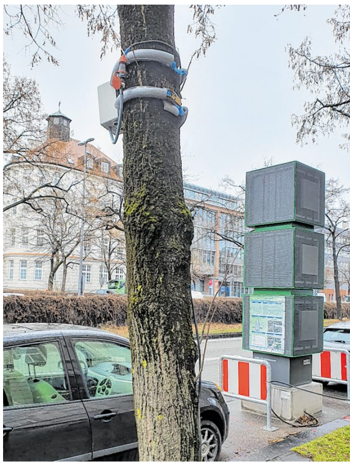
Die Messboxen werden unter anderem an Straßenbäumen befestigt. Im Hintergrund ist eine Filtersäule zu sehen. Foto: Florian Reich
