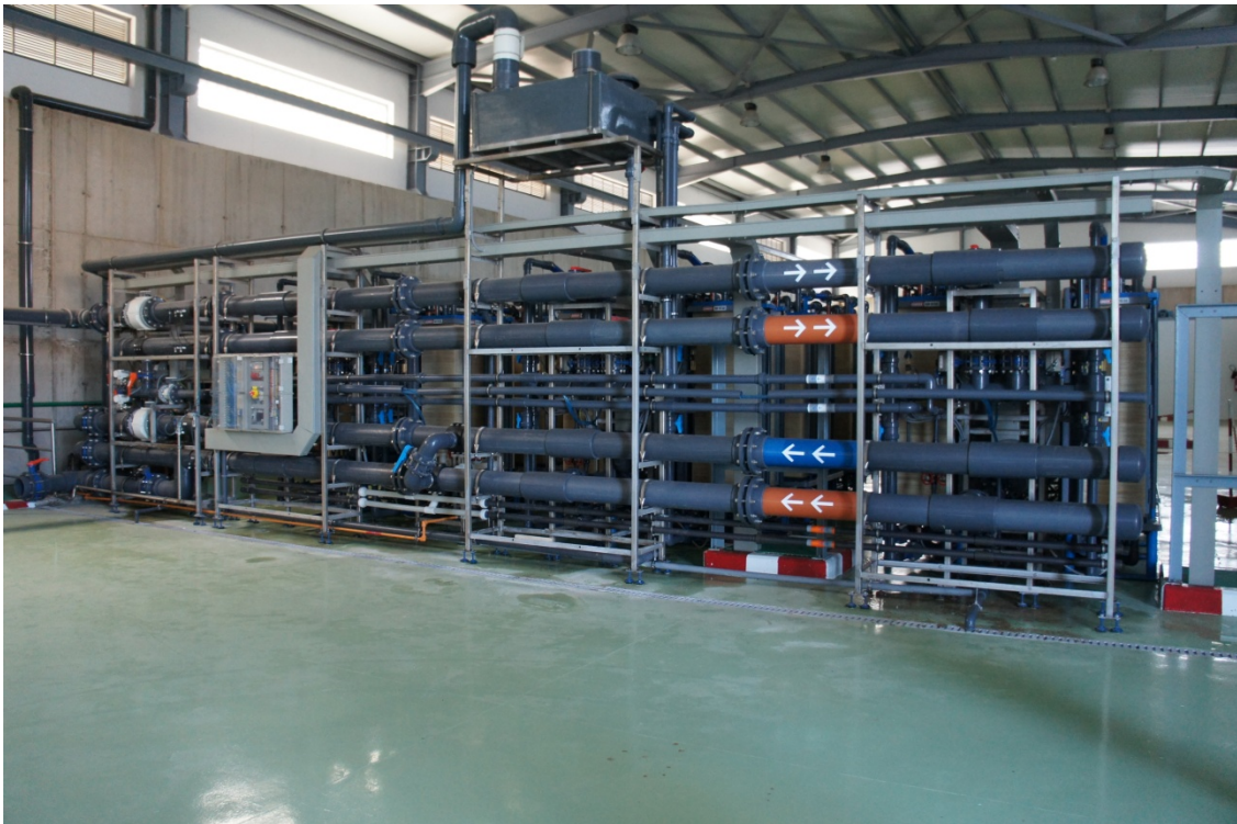
ABBILDUNG 19: ENTSALZUNGSANLAGE DER FIRMA BALTEN COMPANY
