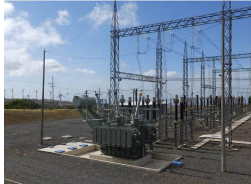
Abb. 51: Planta Eólica Guanacaste bei Guayabo
