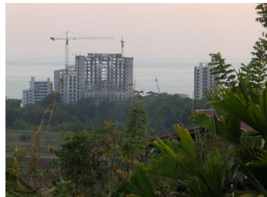
Abb. 34: Investitionsruinen (Hotelbauten) in Jacó
