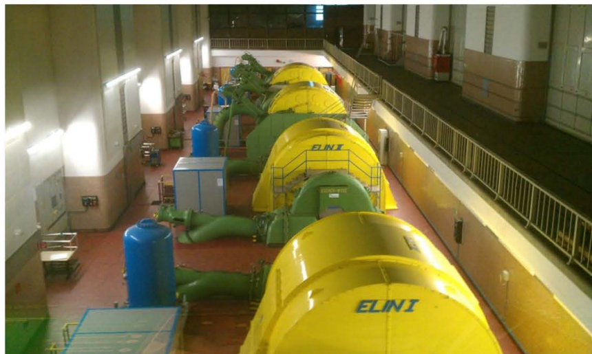
Abbildung 3: Generatorenhalle des Kraftwerks Kaprun
