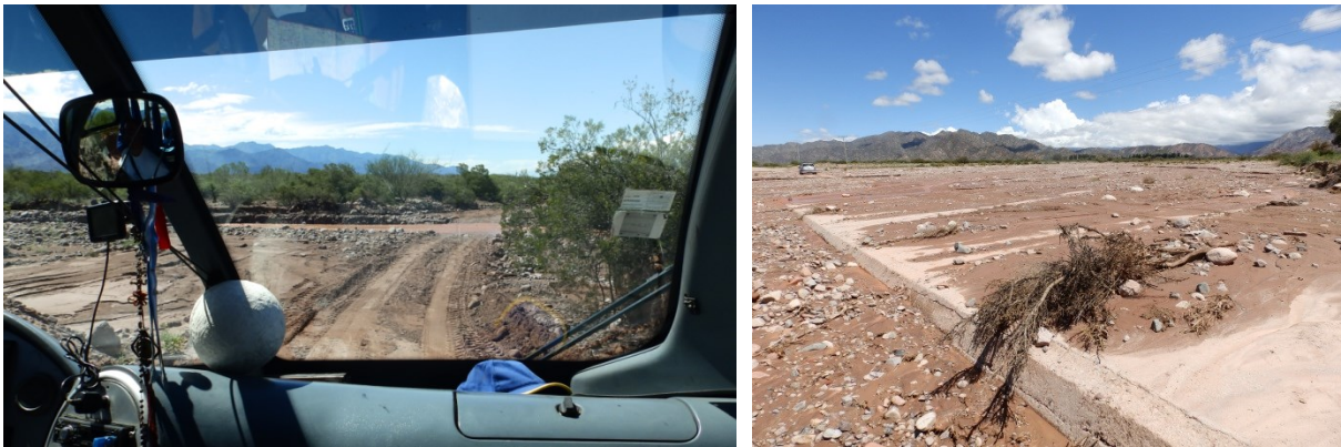
Abb. 123 a und b: Ruta Provincial 11 südlich Tinogasta – Straßenschäden und überstrecte Furt im Gefolge von Unwettern
