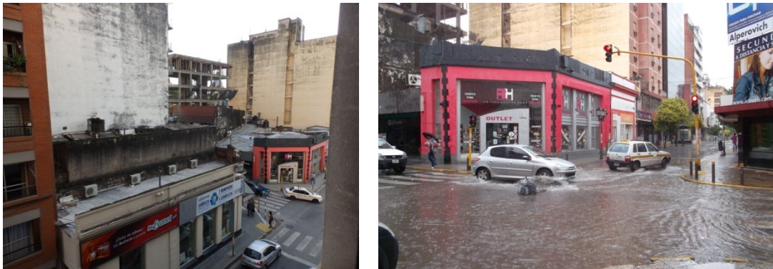
Abb. 245: Spuren starker Feuchtigkeit an den Fassaden ( San Miguel de Tucumán )
