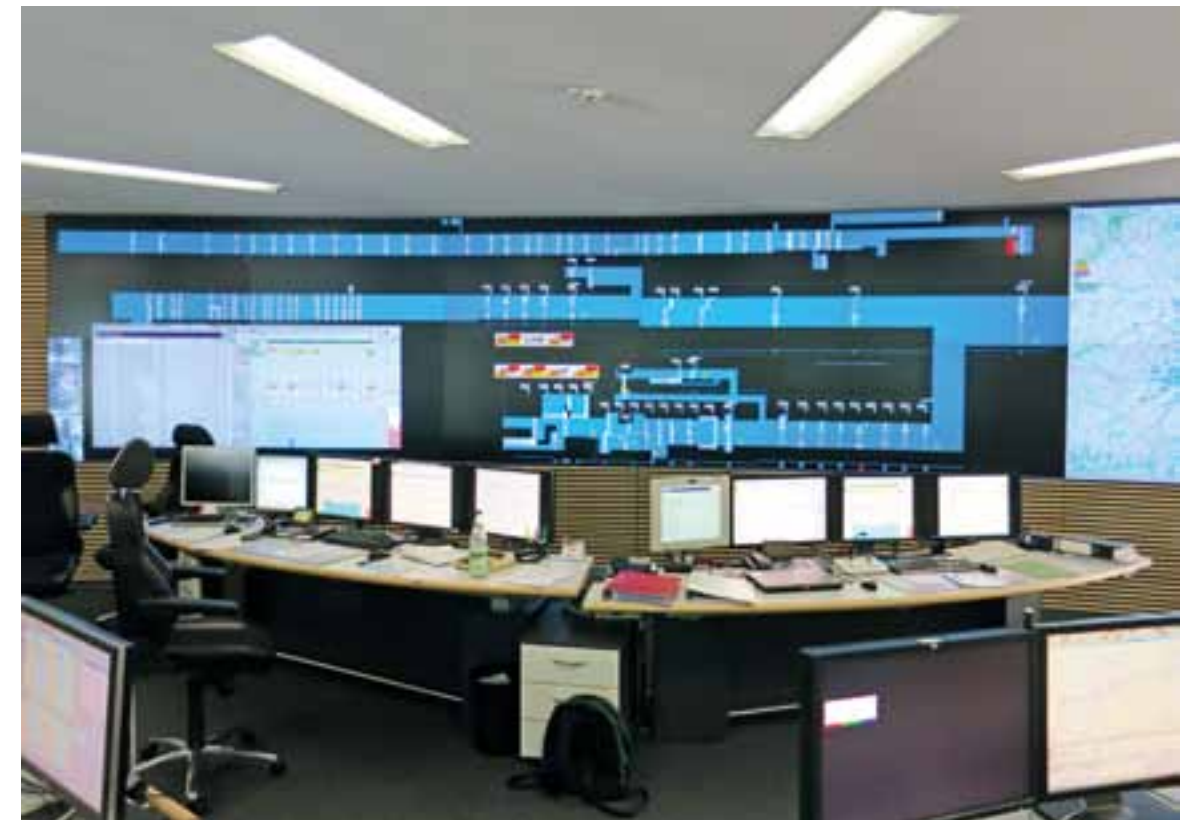
Der Kontrollraum: In der Zentralwarte in Landshut werden mehrere Flüsse »gefahren«, darunter der Lech, 2013 (Foto Jens Soentgen).
